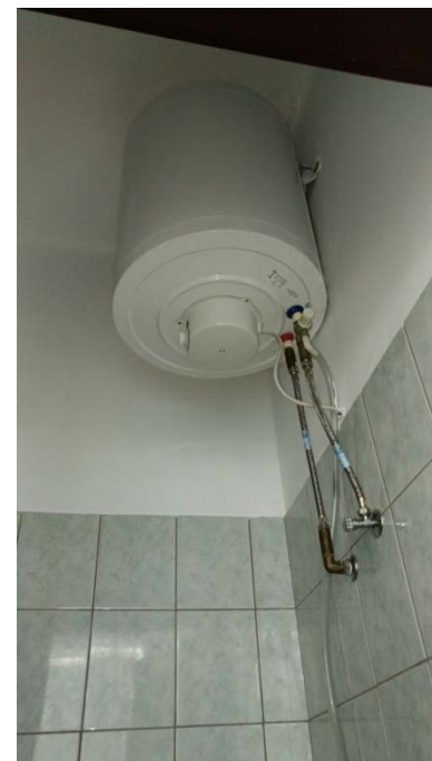
Meleg víz előállítás
