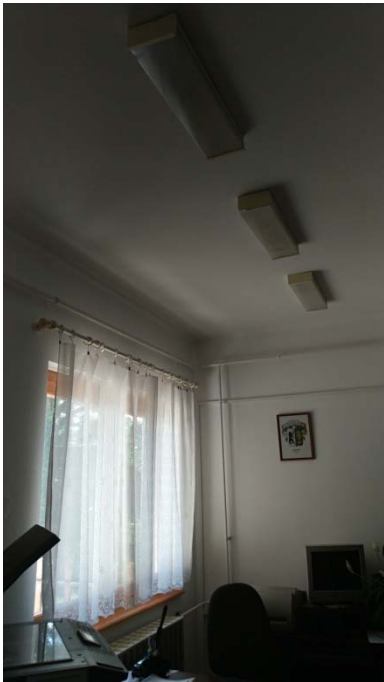
Iroda megvilágítás, és hőleadó
