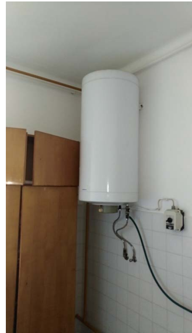
Meleg víz előállítás
